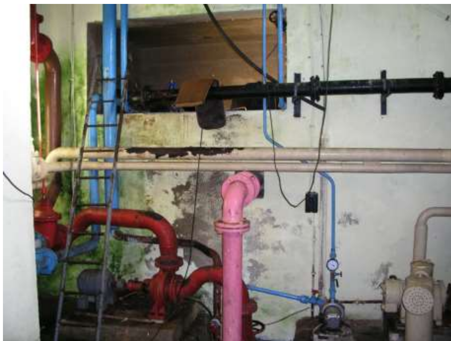
Chambre à vannes et accès à la cuve insalubres
