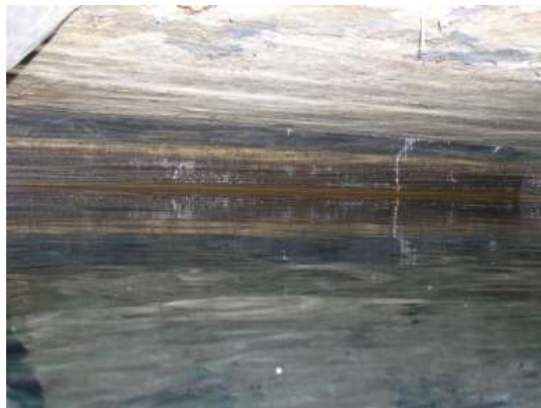
Infiltrations à travers la dalle
