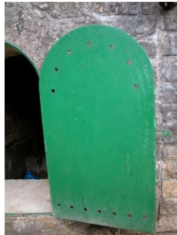
Accès non sécurisé et porte non étanche
