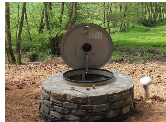
Photo de la chambre de captage Kuelemeeschter
