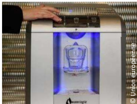
Figure 1 : fontaine à eau installée dans le cadre de la politique de réduction de la consommation de plastique à usage unique
