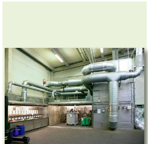
Sortier- und Umfüllstation mit Filteranlage und kontinuierlicher Emissionsüberwachung
