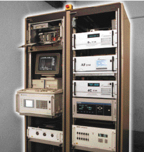
Figure 14 : Equipement de la station de mesure de Luxembourg-Centre.
