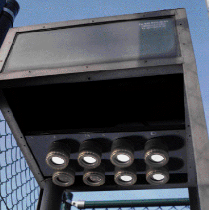
Figure 7: Filtres fixés sur leurs supports-filtres. Station métaux lourds à Esch/Alzette
