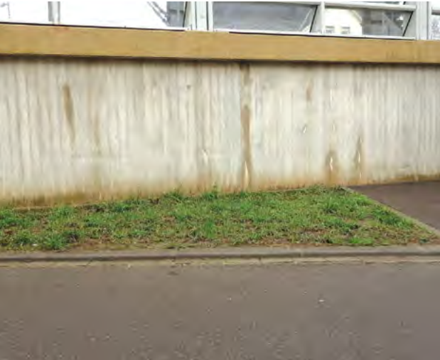
Avant le remplacement du sol : le parterre comporte de nombreuses graminées et adventices problématiques.
